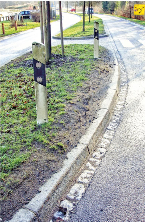
Abbildung 89: Kontinuierliche Streusalzbelastung im Kurvenbereich hat zu einer Verschlämzung der Bodenstruktur geführt sowie zu einem Absterben des Rasens. Die Bäume in diesem Grünstreifen werden regelmäßig ersetzt.
